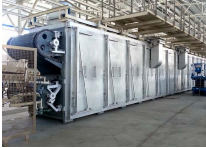
Şekil 9. Kürleştirme ünitesi / Kürleştirme fırını
